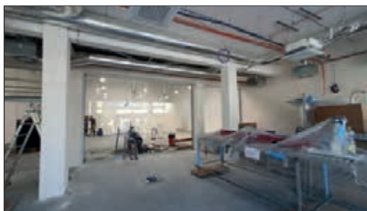
Magazín SELL navštívil Hospitality Center několikrát i během stavebních prací. Fotografie z července, kdy zbýval měsíc a půl do otevření. Vše se stihlo bez zpoždění.
